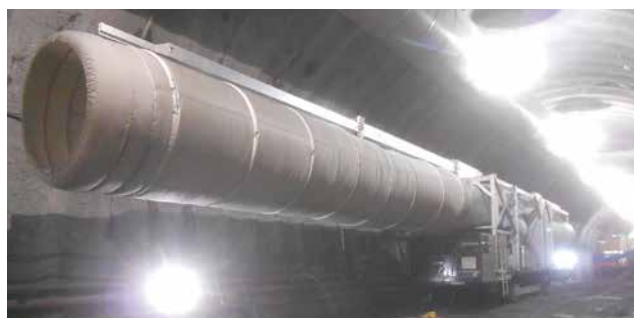
ECステーション (排出側から見る)
