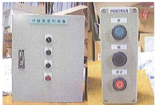
制御盤、リモコンスイッチ
