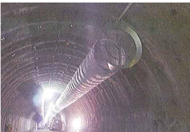
伸縮風管全景
