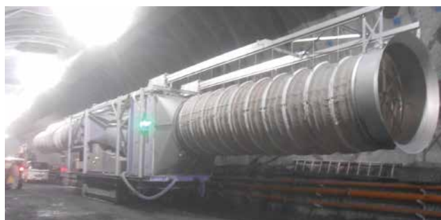
ECステーション (吸込側から見る)
