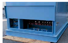
一次側キャブタイヤ取付部
