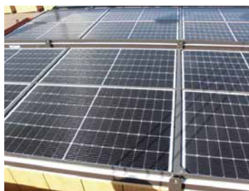
太陽光パネル
