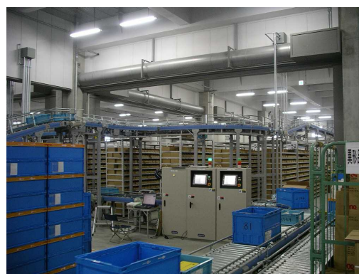
倉庫内に張り巡らされたコンベアライン
